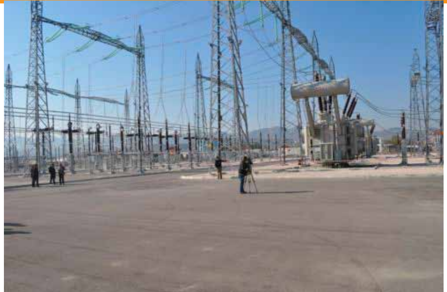
■ Foto: Nënstacioni Tirana 2 në Kashar
